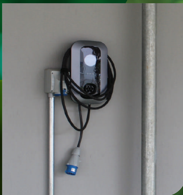
O carregador de carro elétrico no estacionamento da cooperativa está disponível para os cooperados.
